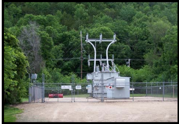
A power substation in Prairie Du Chien
